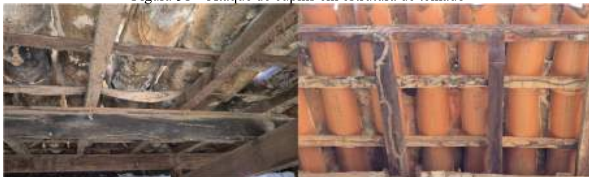
Figura 51 – Ataque de cupins em estrutura de telhado
