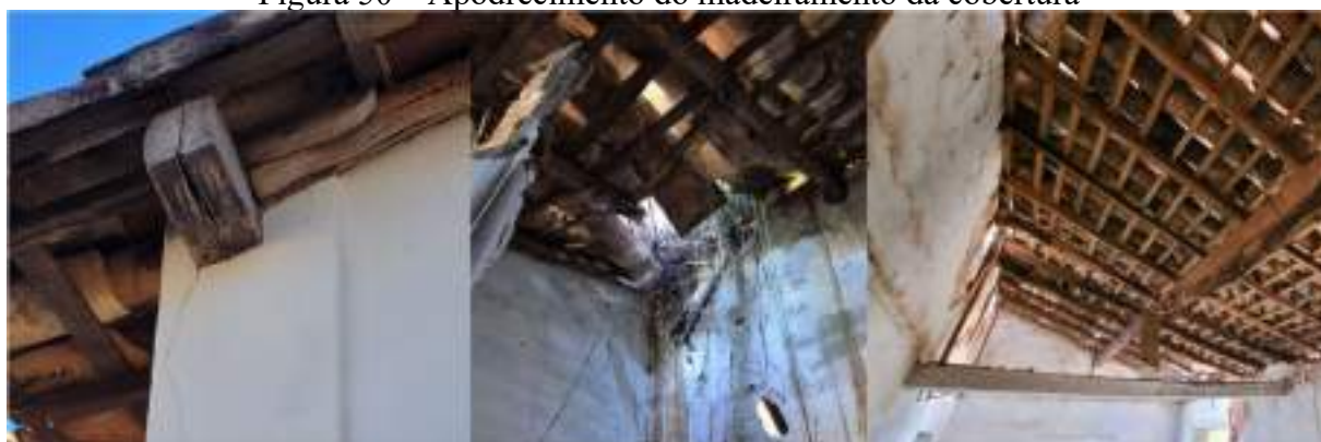
Figura 50 – Apodrecimento do madeiramento da cobertura
