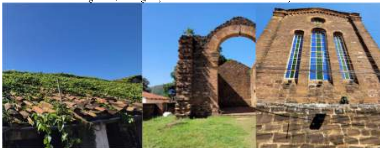
Figura 48 – Vegetação invasora em ruínas e edificações
