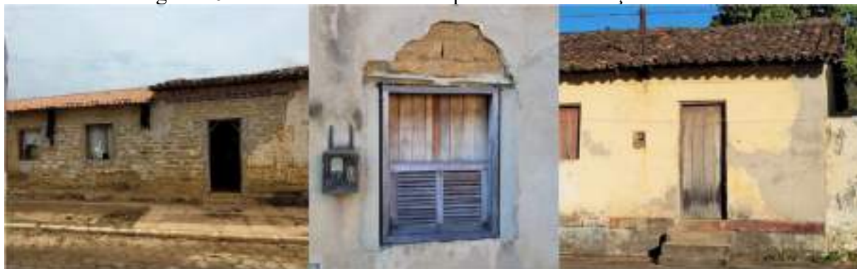
Figura 46 – Uso de material incompatível em edificação histórica
