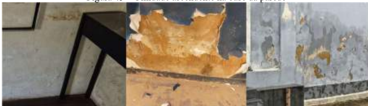
Figura 45 – Umidade ascendente na base da parede
