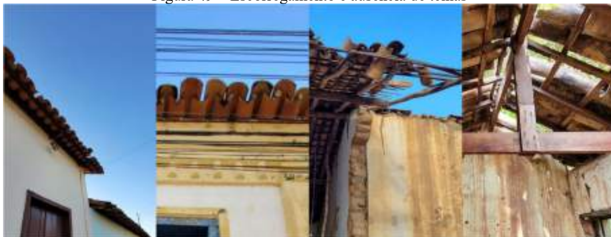
Figura 49 – Escorregamento e ausência de telhas
