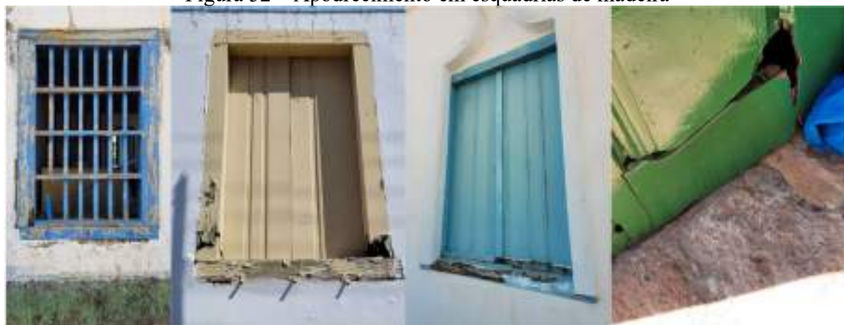
Figura 52 – Apodrecimento em esquadrias de madeira
