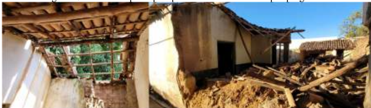
Figura 47 – Parede exposta pela perda da cobertura e colapso progressivo
