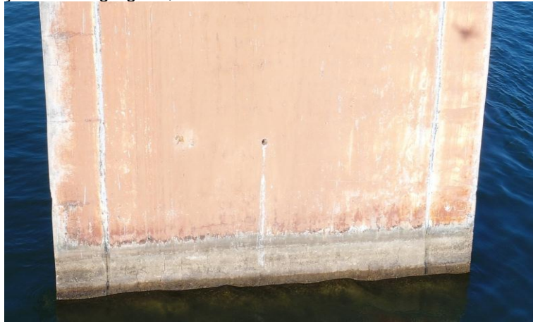
Figura 19: Reação álcali-agregado, e sinais de corrosão das armaduras na face Fátima pilar 3
