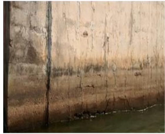
Figura 30: Fissuras e RAA na face montante do pilar 2
