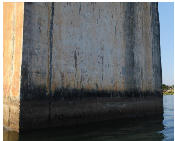
Figura 38: Fissuras e reação álcali-agregado na face montante do pilar 4
