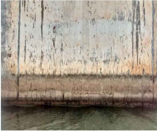
Figura 39: Fissuras na face Porto Nacional do pilar 4
