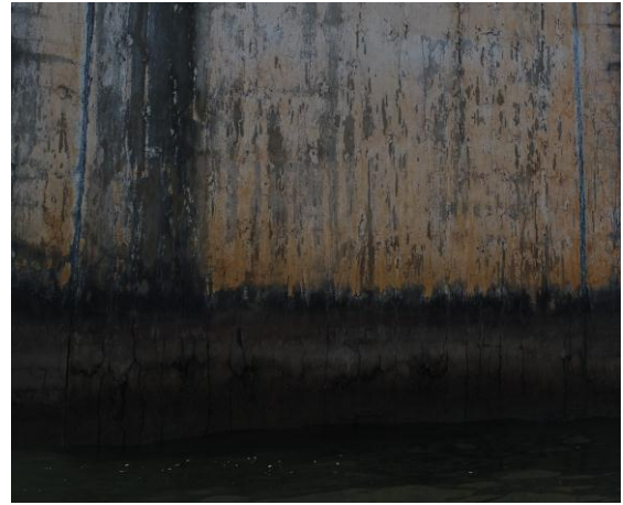
Figura 44: Fissuras e reação álcali-agregado na face montante do pilar 5.
