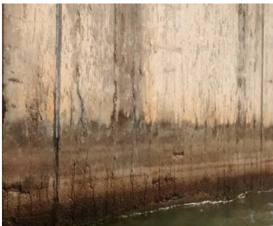
Figura 37: Fissuras e reação álcali-agregado na face montante do pilar 4
