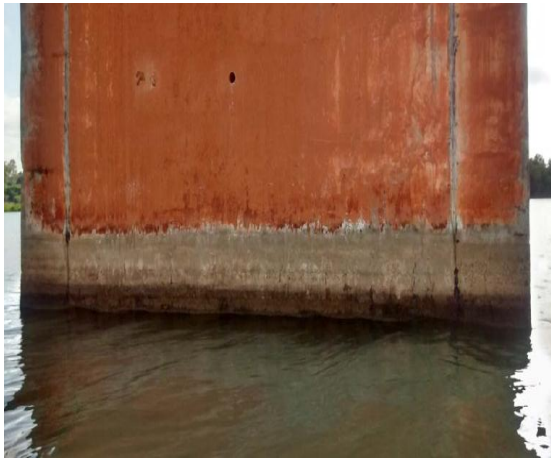
Figura 33: Fissuras e reação álcali-agregado na face Fátima do pilar 3.
