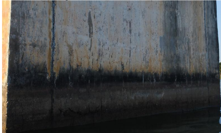
Figura 21: Reação álcali-agregado, nichos de concretagem, muitas fissuras na parte do pilar rente a água na face montante em P4
