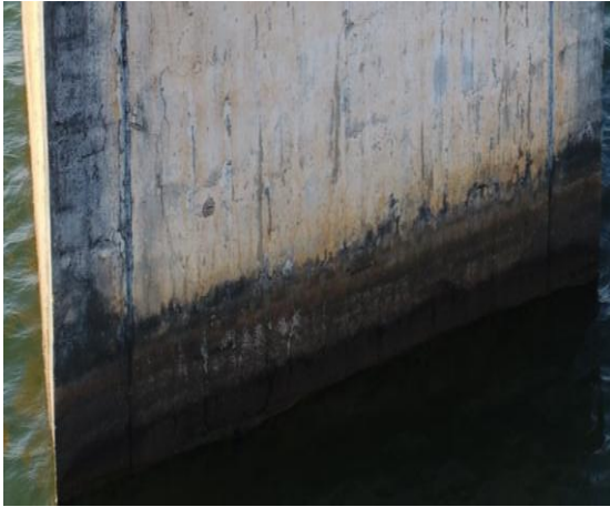
Figura 29: Fissuras e RAA na face montante do pilar 2
