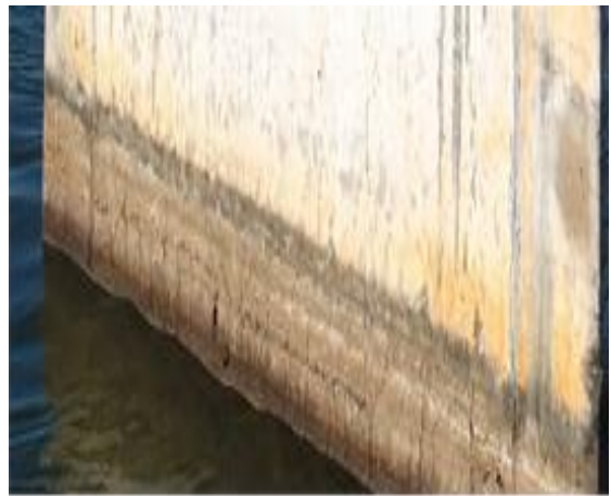
Figura 42: Fissuras e RAA na face Fátima do pilar 4
