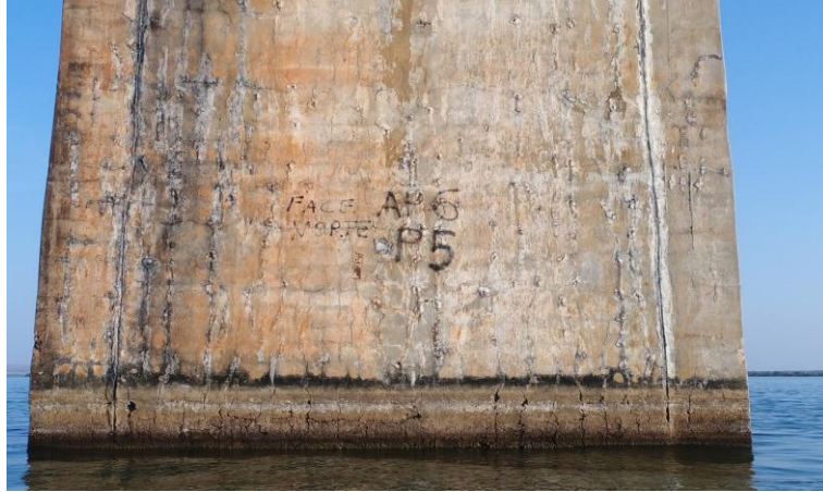
Figura 25: Produtos resultantes da oxidação, fissuras, infiltrações e lodo na face jusante em P5
