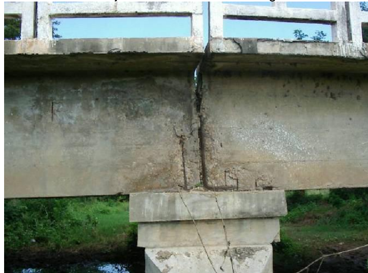
Figura 9 - Abertura da junta do tabuleiro e esmagamento do concreto
