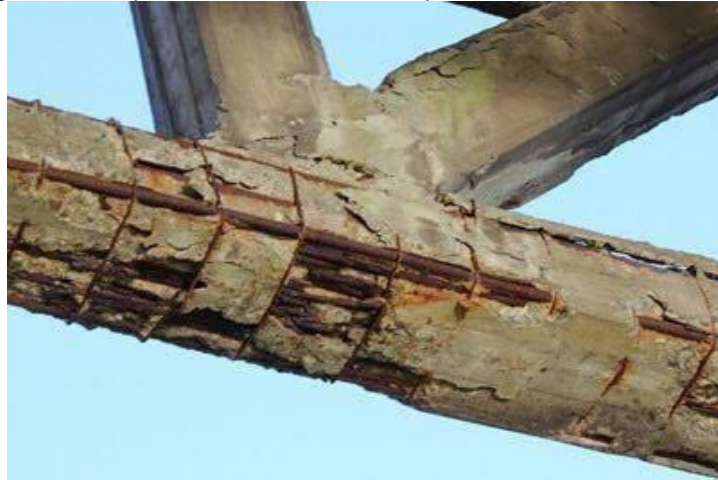
Figura 8- Deslocamento do concreto por corrosão das armaduras
