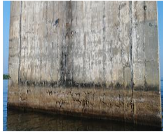
Figura 36: Fissuras e RAA na face jusante do pilar 4.
