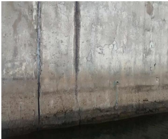
Figura 27: Fissuras na face jusante do pilar 2
