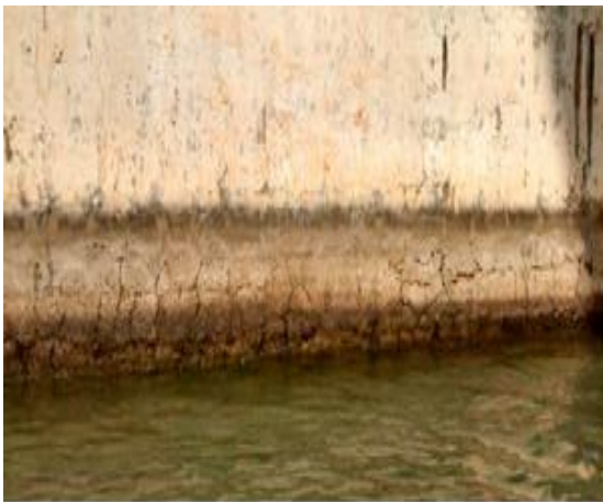
Figura 41: Fissuras e RAA na face Fátima do pilar 4
