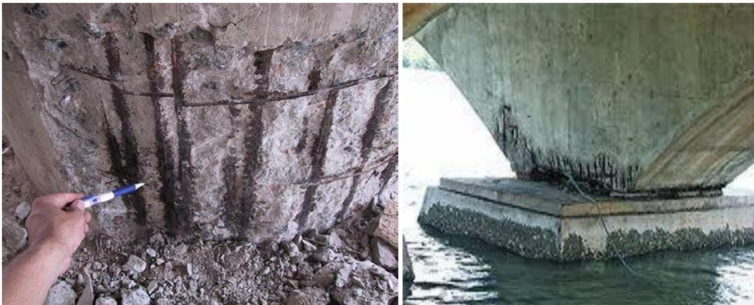
Figura 7- Corrosão da armadura e desagregação do concreto
