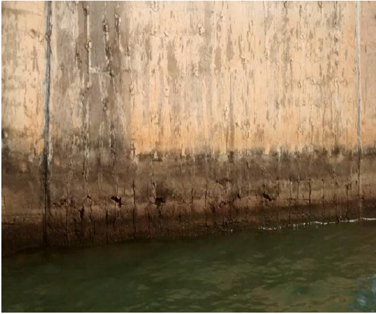
Figura 43: Fissuras e reação álcali-agregado na face montante do pilar 5.
