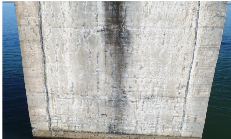
Figura 20: Reação álcali-agregado, manchas de umidade e lodo na face jusante pilar 3
