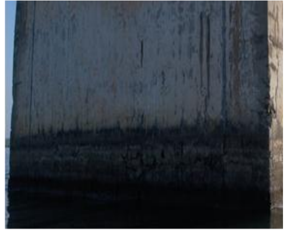
Figura 40: Fissuras na face Porto Nacional do pilar 4
