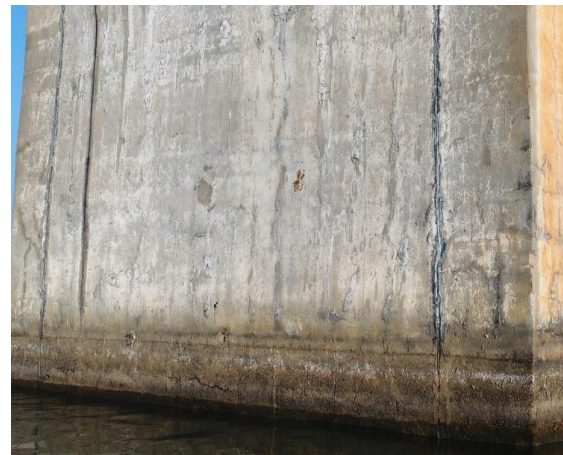
Figura 28: Fissuras na face jusante do pilar 2
