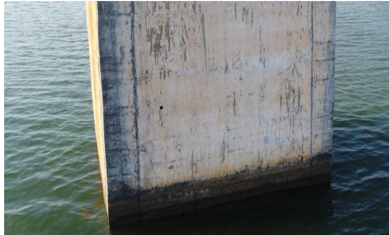
Figura 17: Reação álcali-agregado, manchas de umidade em P2, face montante
