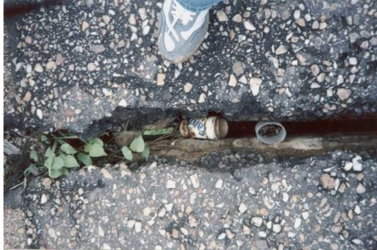
Figura 10- Abertura excessiva da junta de dilatação do tabuleiro
