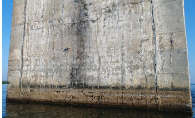
Figura 24: Eflorescência, nichos de concretagem e bolor na face jusante em P4
