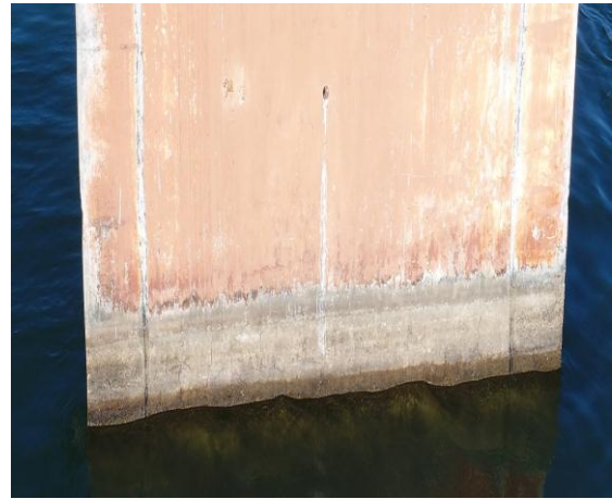
Figura 34: Fissuras e reação álcali-agregado na face Fátima do pilar 3.
