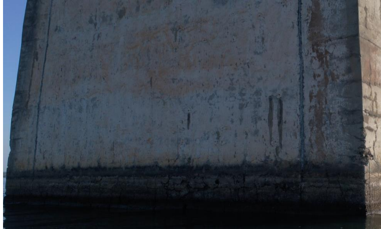
Figura 23: Manchas de infiltração na face Porto Nacional em P4
