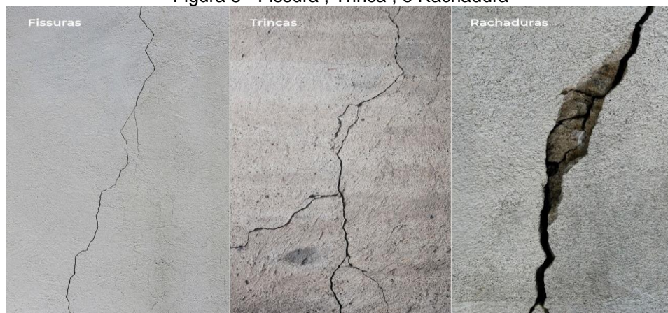
Figura 5 - Fissura , Trinca , e Rachadura
