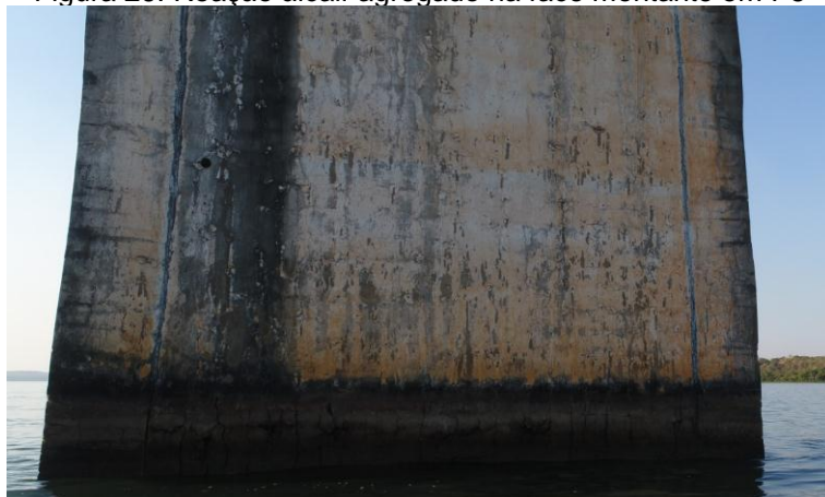
Figura 26: Reação álcali-agregado na face montante em P5
