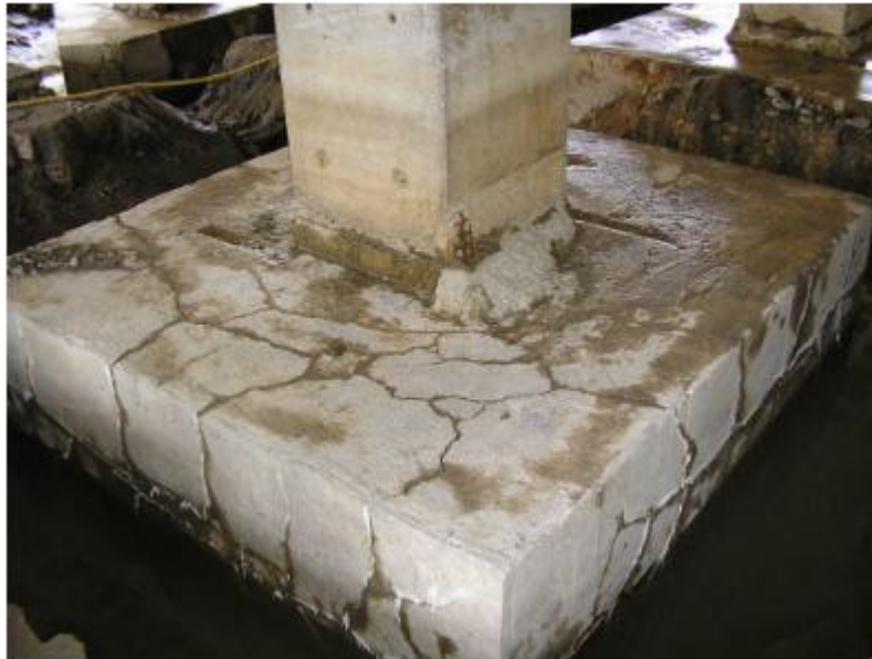
Figura 6: Bloco de fundação com padrão de fissuração típico de RAA
