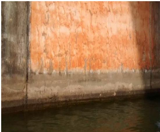
Figura 31: Fissuras na face Porto Nacional do pilar 3
