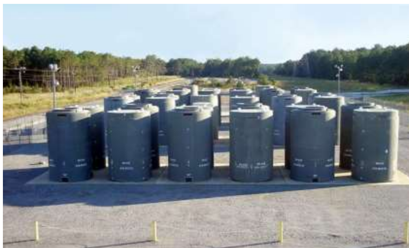
Figura 21- Exemplo de uma instalação com módulos de armazenamento a seco.
