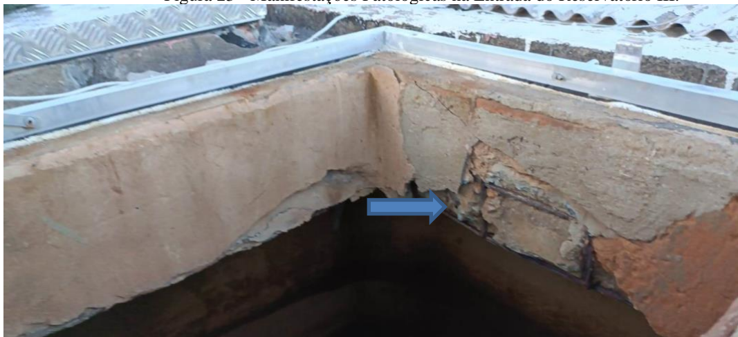
Figura 23 - Manifestações Patológicas na Entrada do Reservatório III.
