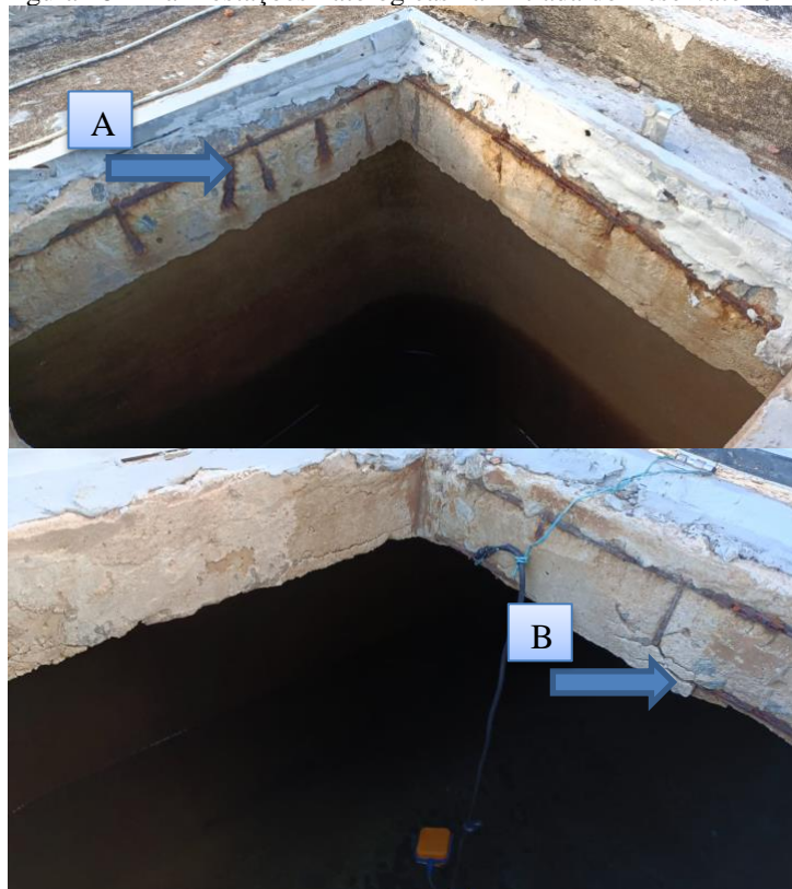
Figura 18 - Manifestações Patológicas na Entrada do Reservatório II.
