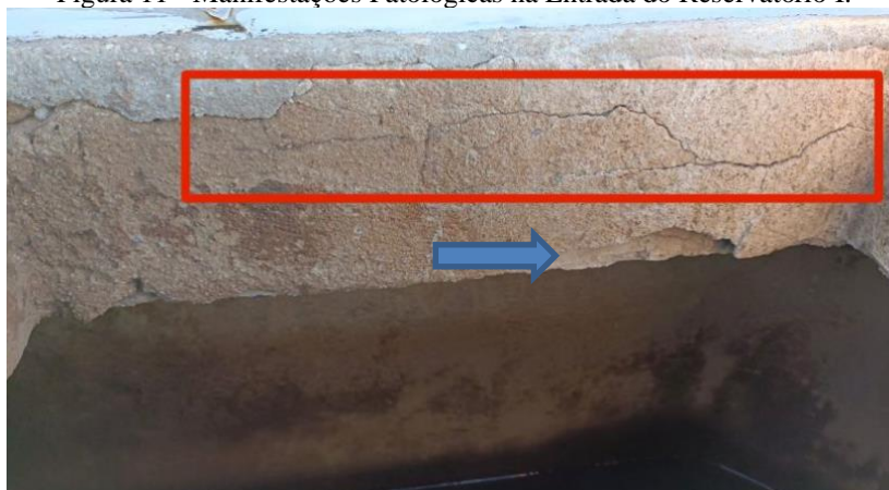
Figura 11 - Manifestações Patológicas na Entrada do Reservatório I.
