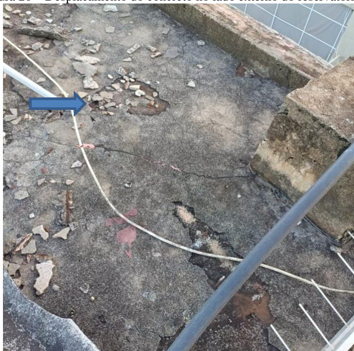
Figura 20 – Desplacamento do concreto no lado externo do reservatório III.
