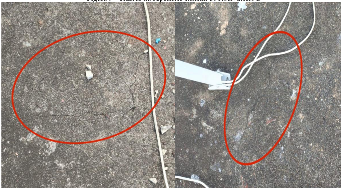
Figura 9 - Trincas na superfície externa do reservatório I.
