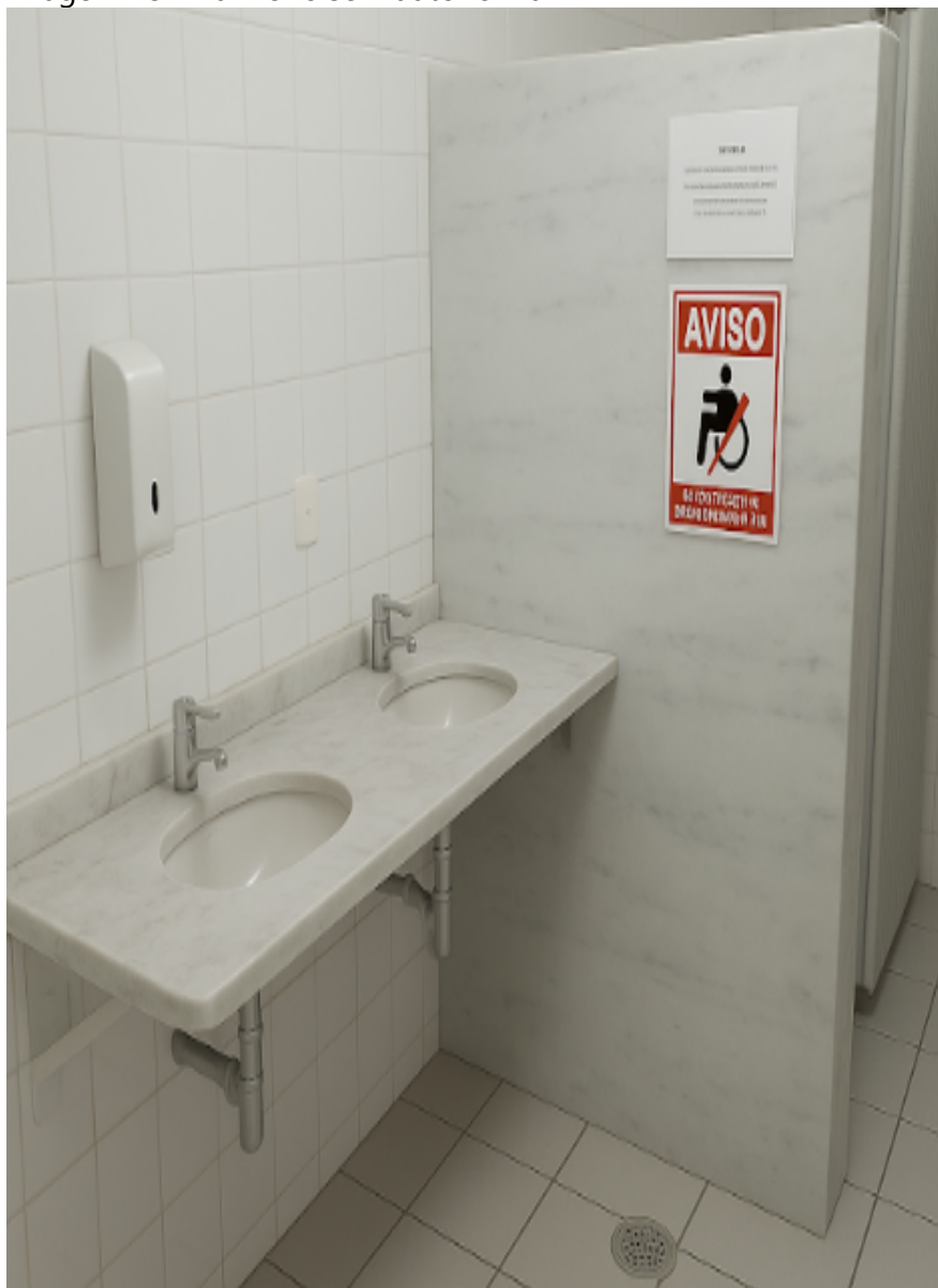
Imagem 48 – Banheiro sem autonomia
