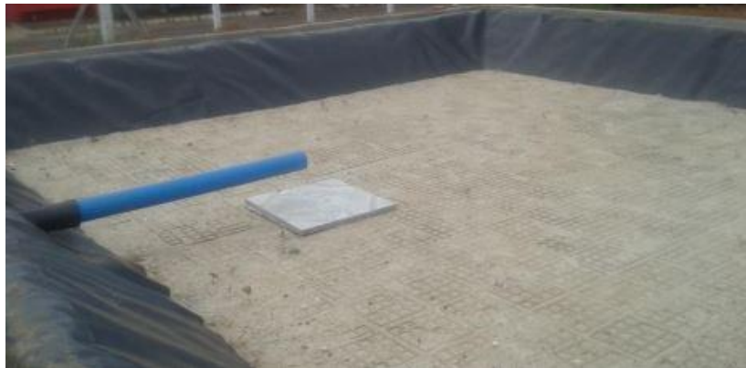
Figura 7 - Leito de secagem para recebimento de lodo adensado
