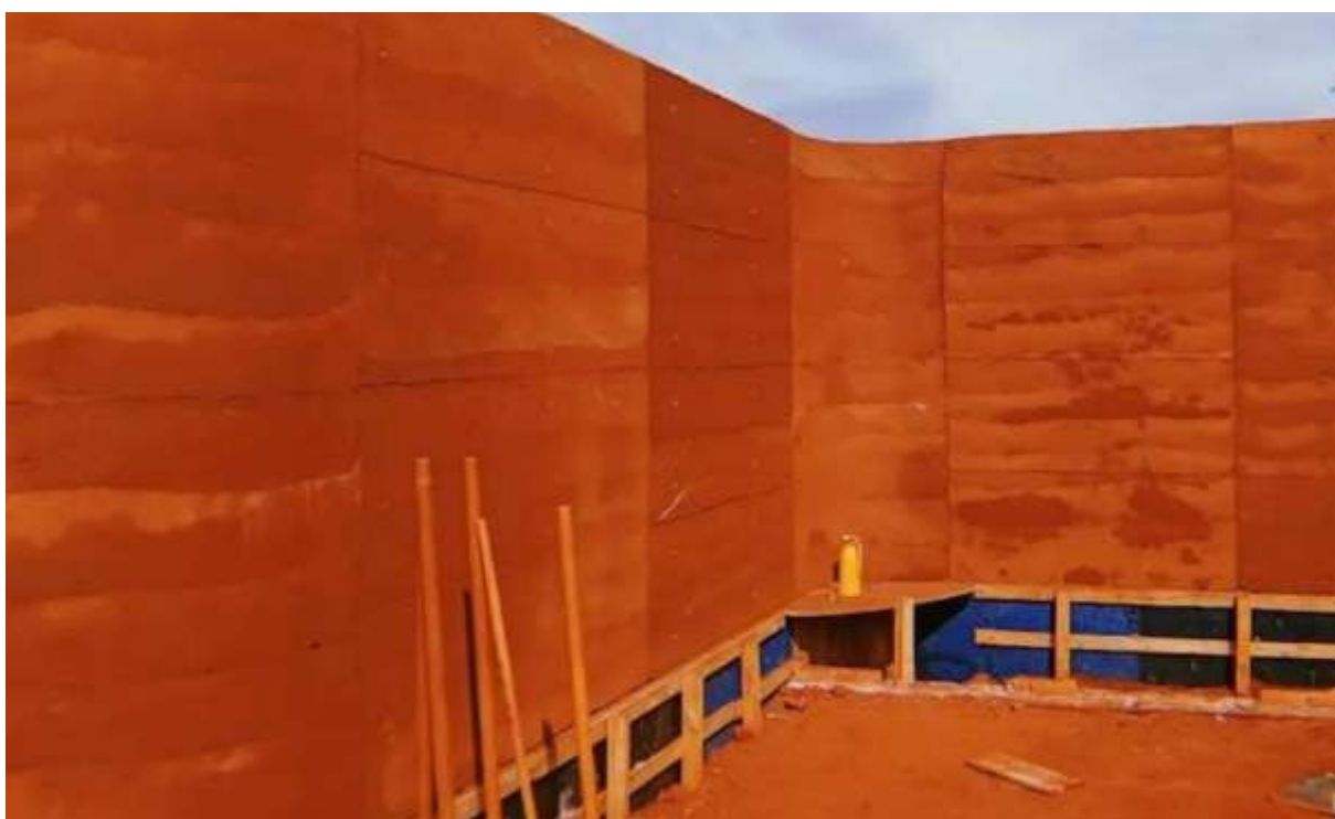
Figura VI – Parede de taipa de pilão da residência J e K, São Paulo
