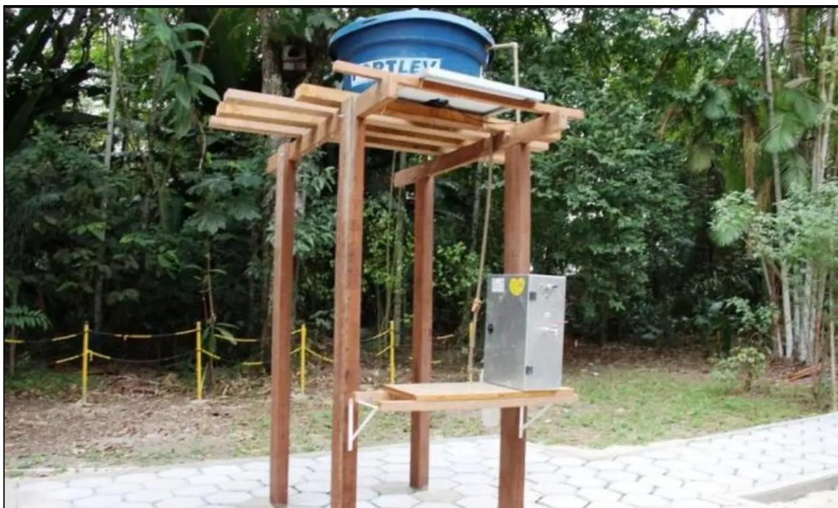
Figura 21. Sistema de tratamento de água com uso de energia solar FV.
