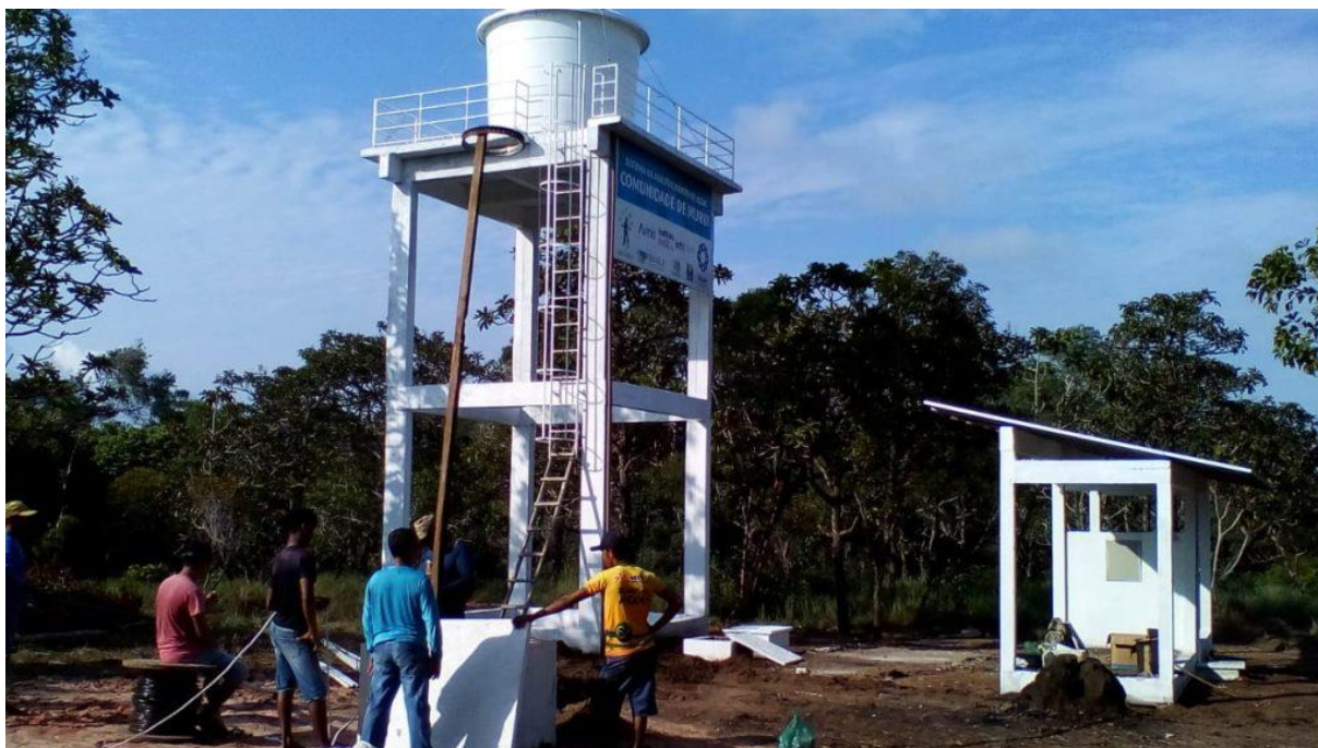
Figura 22. Sistema de abastecimento de água na comunidade Murui, em Santarém, no oeste do Pará.
