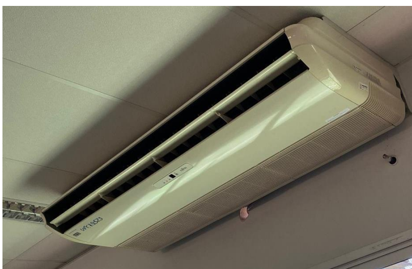
Figura 11 - Ar condicionado modelo piso teto marca Fujitsu
