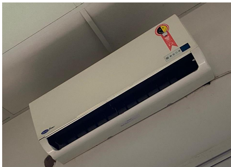
Figura 10 - Ar condicionado modelo Split marca Carrier
