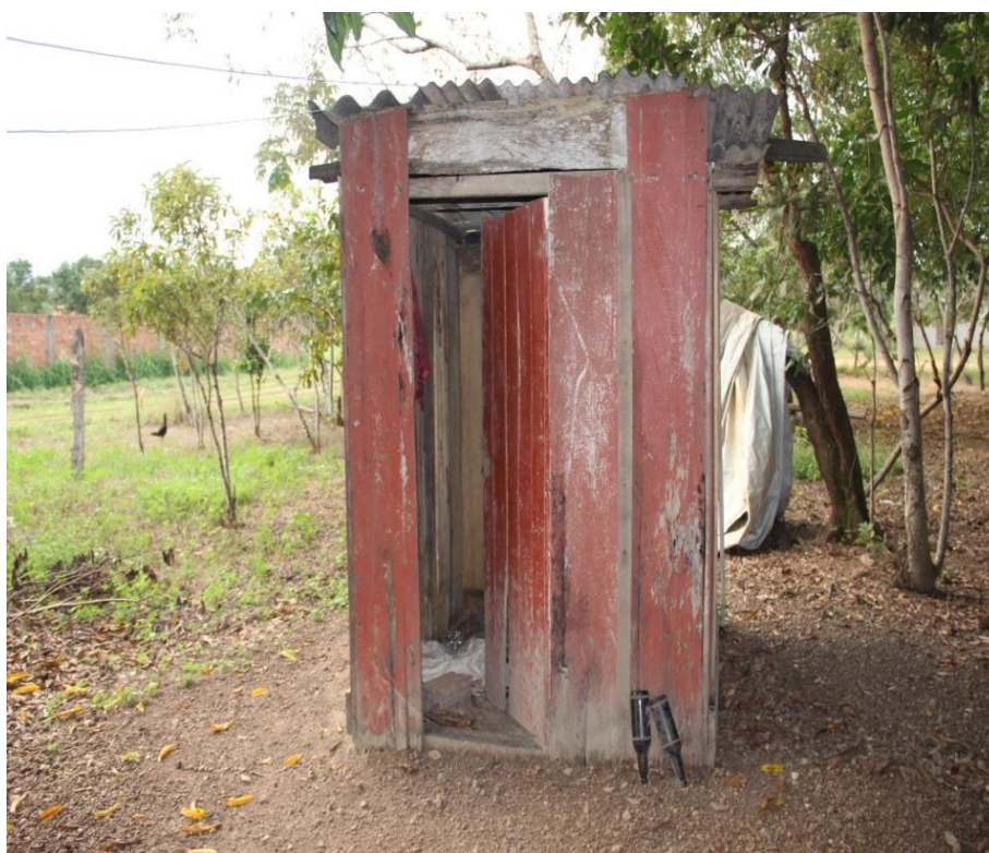
Figura 19 - banheiro desativado na casa de um pescador.
