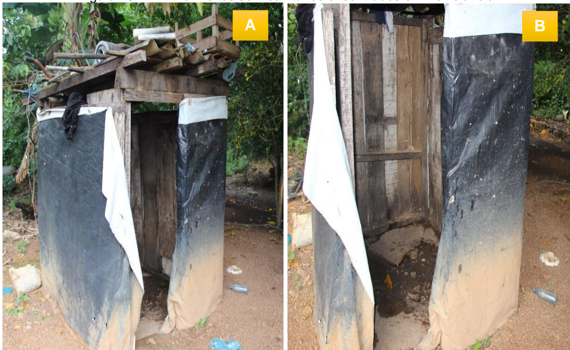
Figura 13 A - B. Banheiros sem sanitários encontrados em Peixelândia.
