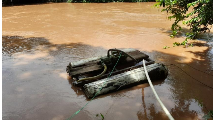
Figura 15 – Equipamento para captação de água no rio Sobrado – Fazenda Tamburil
