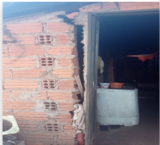
Imagem 4. Rachaduras em uma residência com riscos de desmoronamento
