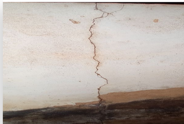
Imagem 2. Imagens com fissuras e rachaduras na residência
