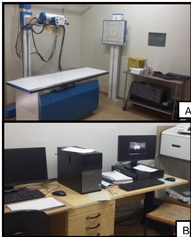
Figura 4 – A: Sala de exames radiográficos com aparelho Equimex 300 mA, 100 Kv e 1,0 T; B: Sala de laudos radiográficos com um digitalizador de imagem modelo Caresteram modelo DiretView Vita CR e uma impressora DryView 5700 Lazer Imager. Fonte: CVU, 2017.
