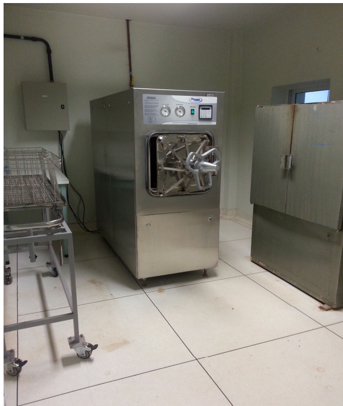
Figura 10. Sala de esterilização do HV-UFU. Campus de Umuarama, Minas Gerais. Arquivo pessoal (2016).
