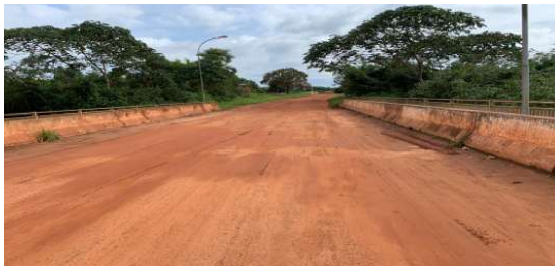
Figura 10 – Ponte no final da Avenida Elói Corrêa-Goiatins com acesso a estrada de vicinal divisa TO/MA.
