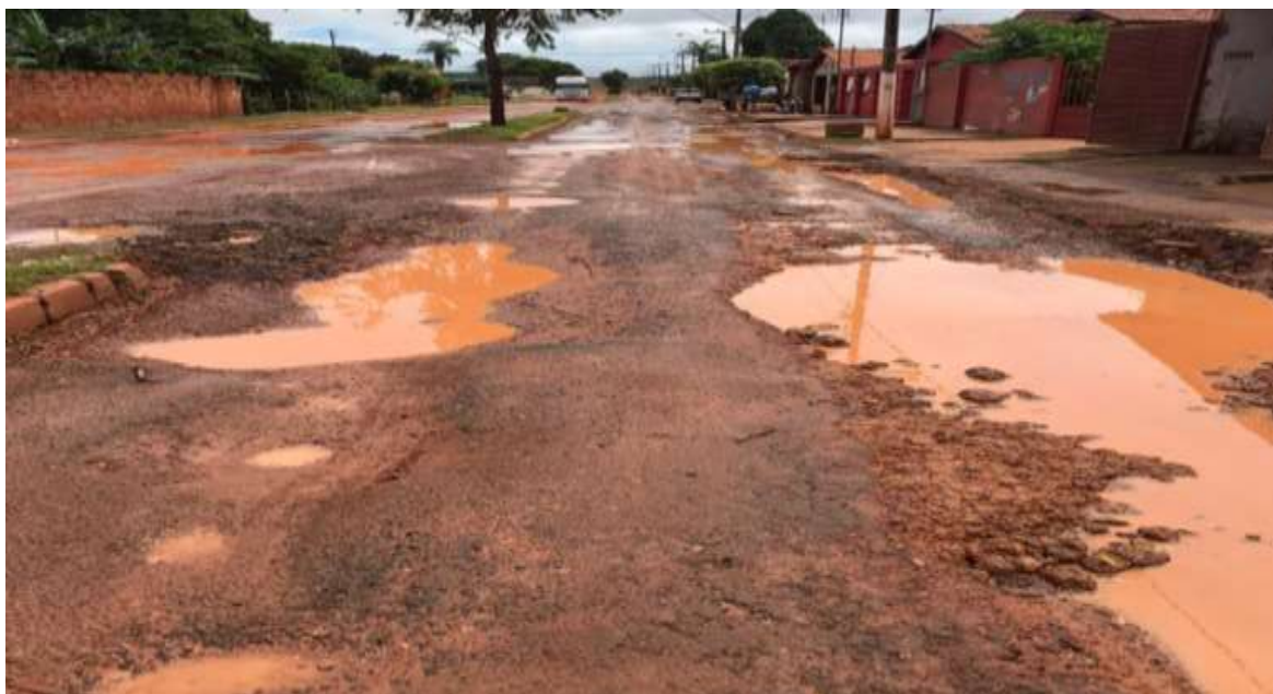
Figura 8 - Trânsito de veículos pesados deixa avenida central em péssimas condições
