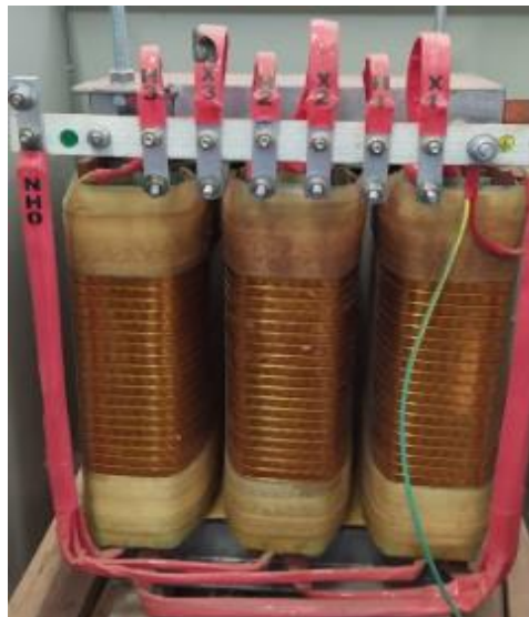
Figura 25 - Vista Frontal do Autotransformador
