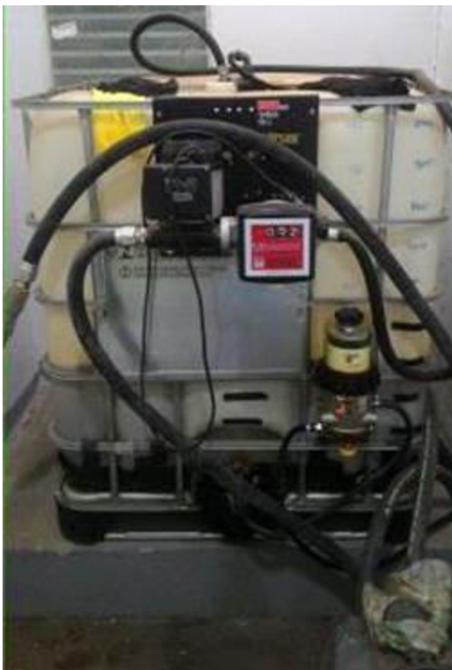
Figura 13 Tanque combustível de abastecimento
